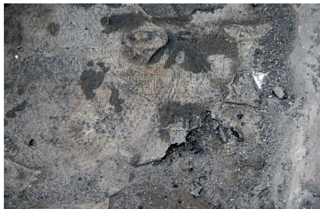
Bild 4 Zerstörung einer ca. 35 Jahre alten Bitumenschweißbahn mit hoher Trägereinlage unter einer 70 mm dicken Asphaltsschicht. Destruction of a 35-year-old bitumen sheet with raised reinforcement under a 70 mm thick asphalt layer.
