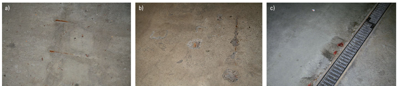
Bild 1 Fotos von typischen Korrosionsschädigungen auf ca. 20–30 Jahre alten Bodenplatten; a) Einzelne korrodierte Bewehrungsstäbe – örtlich begrenzt; b) Punktuelle Bewehrungskorrosion mit Betonausbruch; c) Kleinere Korrosionsschäden neben Rinnen Photos of typical corrosion damages on about 20–30 year old baseplates; a) Individual corroded reinforcement bars-locally limited; b) Spot corrosion of reinforcements with concrete outburst; c) Minor corrosion damage beside drainage gullies
